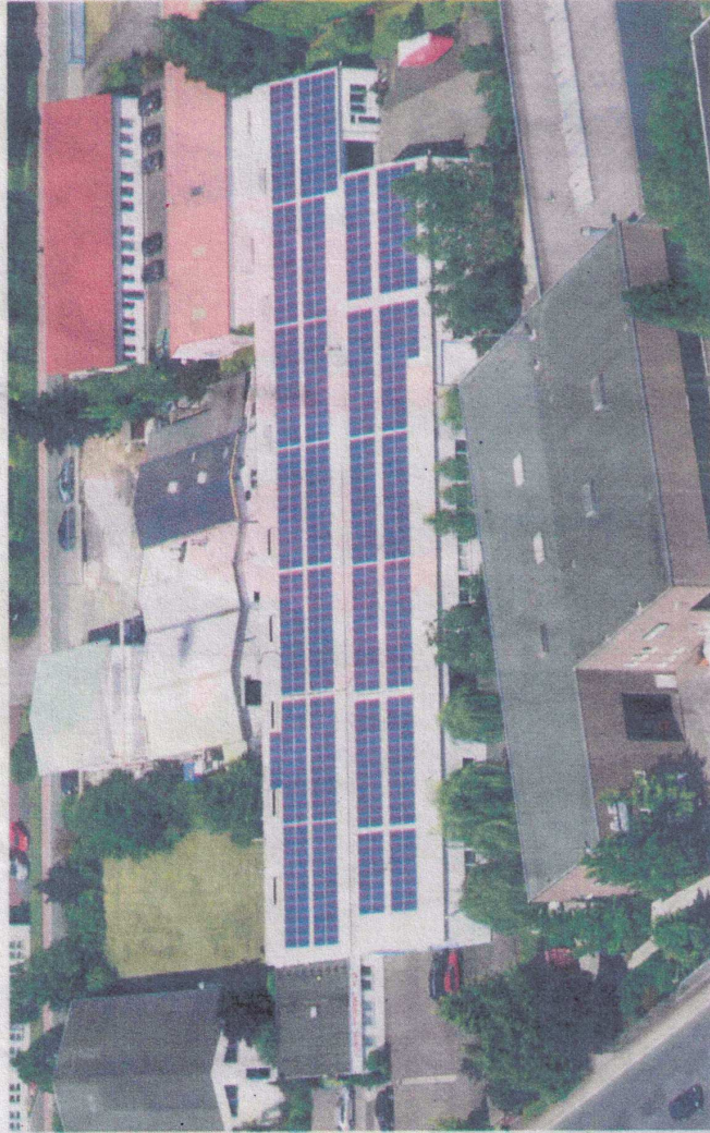
Aus luftiger Höhe ist die Dimension der neuen Photovoltaikanlage auf den Produktionshallen der Carl Fürst KG gut zu erkennen.
